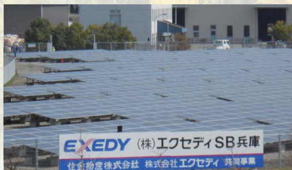
出力規模：約1,750kWのメガソーラー
